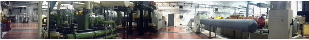
Vue panoramique du hall des groupes de pompage de la plateforme FAST
